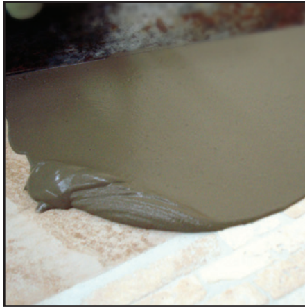
PRO PATCH SUPRÊME™ utilisé comme produit de nivellement des reliefs au-dessus des carreaux de céramique existants
